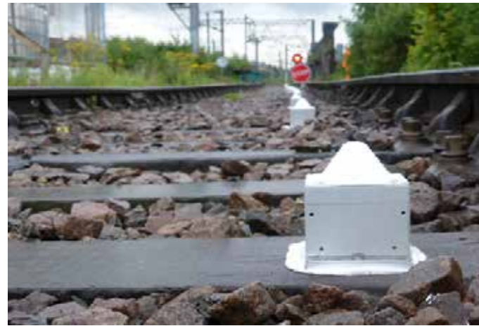
Bild 12: Gleisüberwachung mittels drahtloser Neigungssensoren
