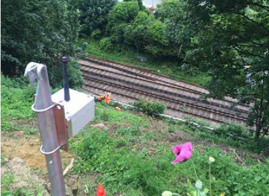
Bild 8: Hangüberwachung mittels an Erdspießen montierten drahtlosen Neigungssensoren
